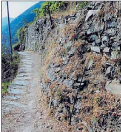
Esempio di traslazione alla base del muro dovuta probabilmente alla spinta del terreno.
