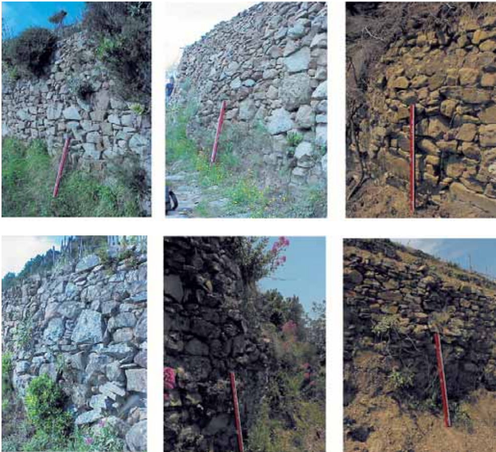
Esempi di fenomenomeni di "spanciamiento"
