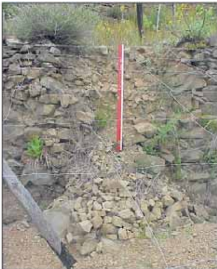
Particolari dell'evoluzione di un fenomeno di "spanciamento" in crollo.
