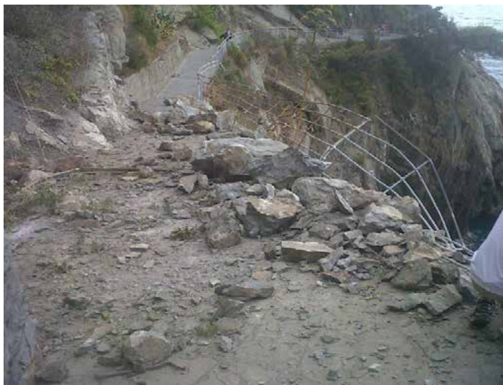
Figura 18. Frana sulla Via dell'Amore
