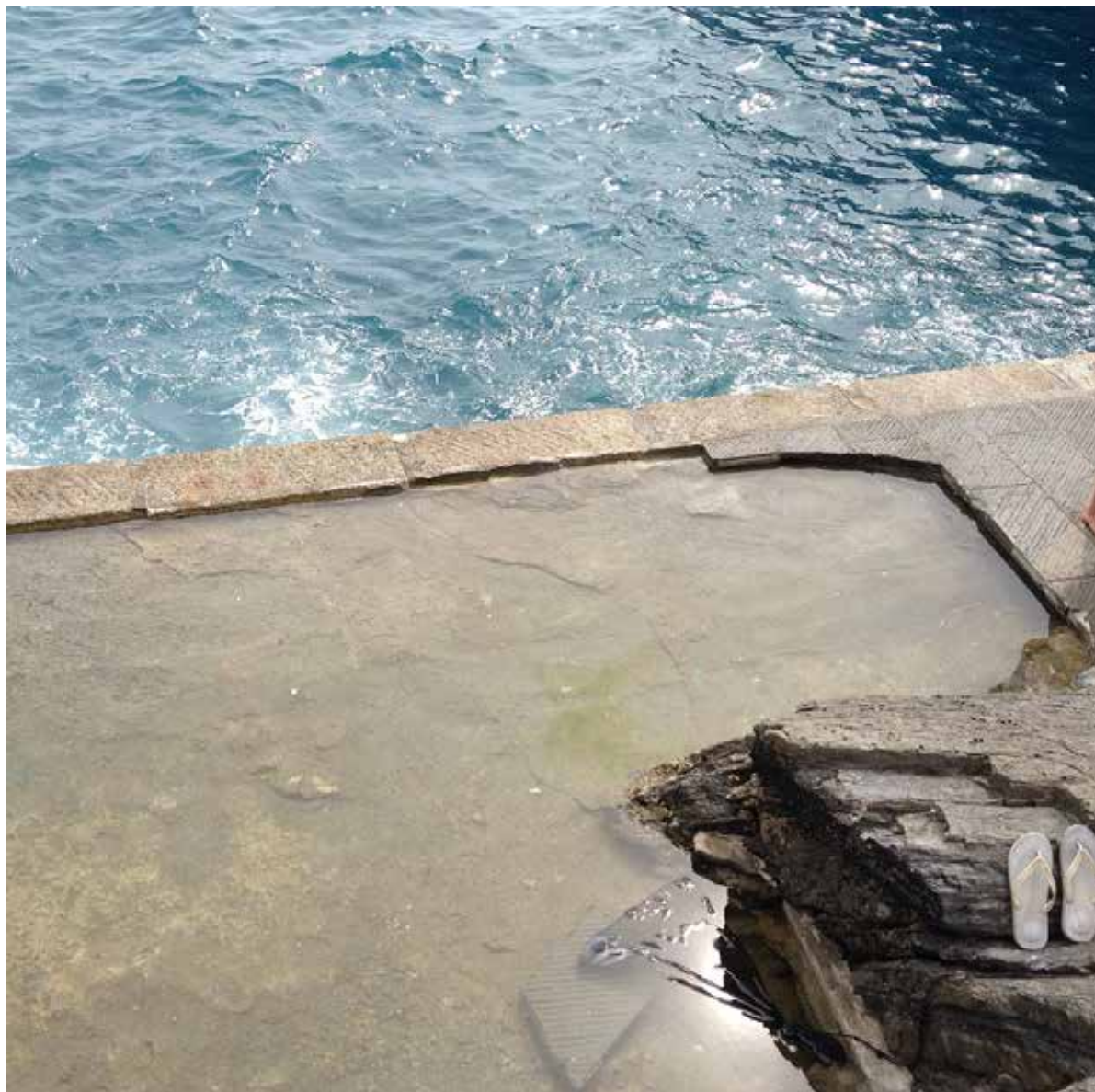
Figura 18. La pavimentazione di Ventegà dopo l'alluvione
