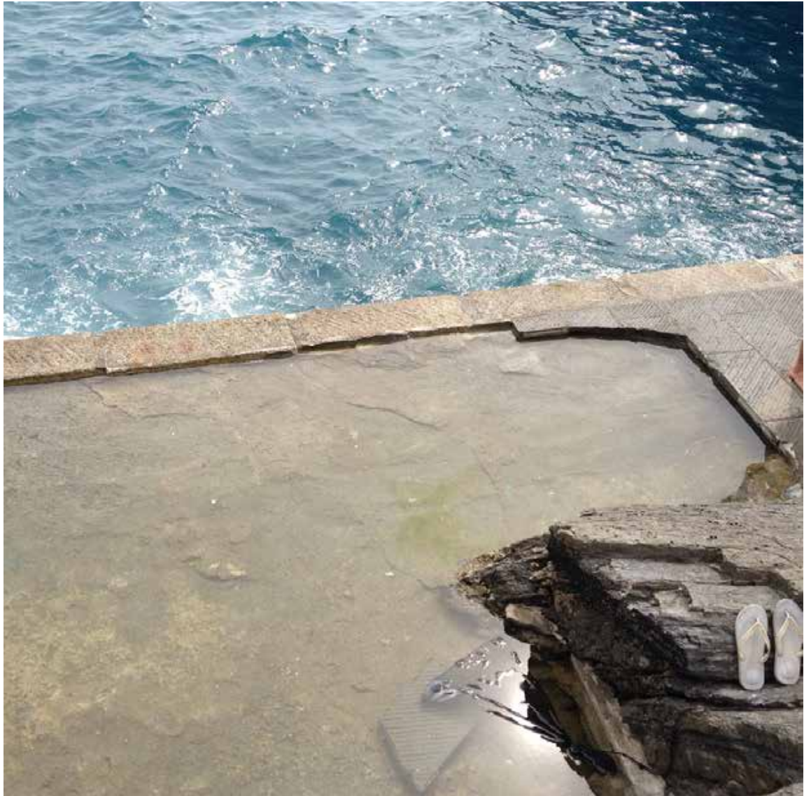
Figura 18. La pavimentazione di Ventegà dopo l'alluvione
